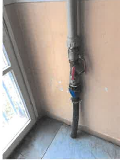
Vodovodná prípojka v budove
